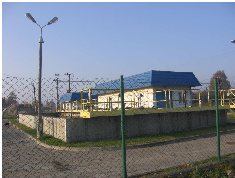
Rysunek 12 Gminna oczyszczalnia ścieków w miejscowości Czernikowo
